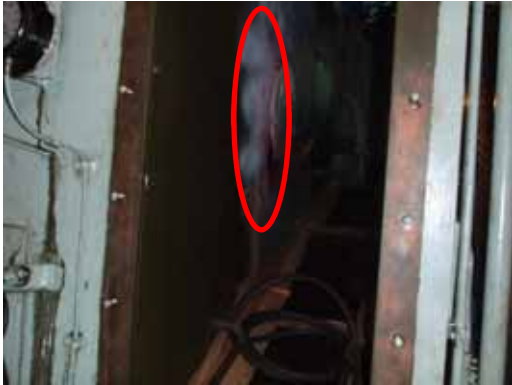
ギア固定壁に約300mmのクラックが発生
