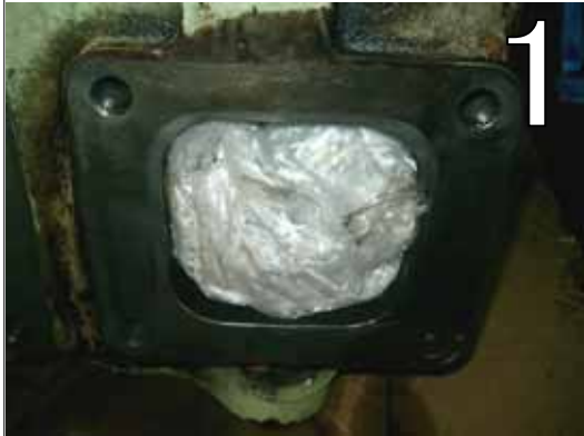
発電機排気ポート状況
