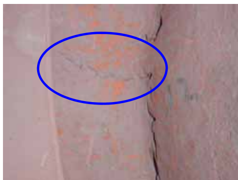
ヤンキードライヤー内部軸受付近に亀裂が発生
