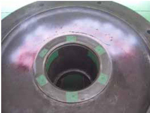
フランジ外周側に約450mmの亀裂が発生
