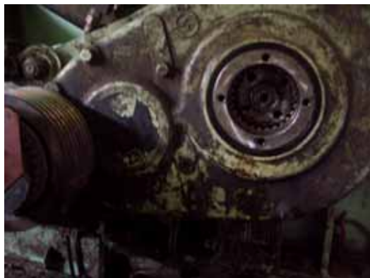
減速機の駆動シャフトとカップリングフランジを連結するボルト穴が損傷
