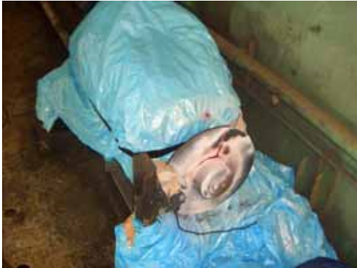
天井クレーンブレーキ外観
