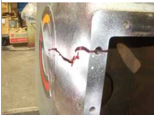
タンクボルト穴を横切るようにクラックが発生
