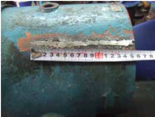
クラックが発生し、溶接補修済み
