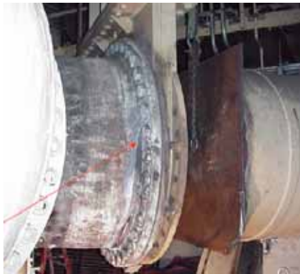
クラック発生状況
